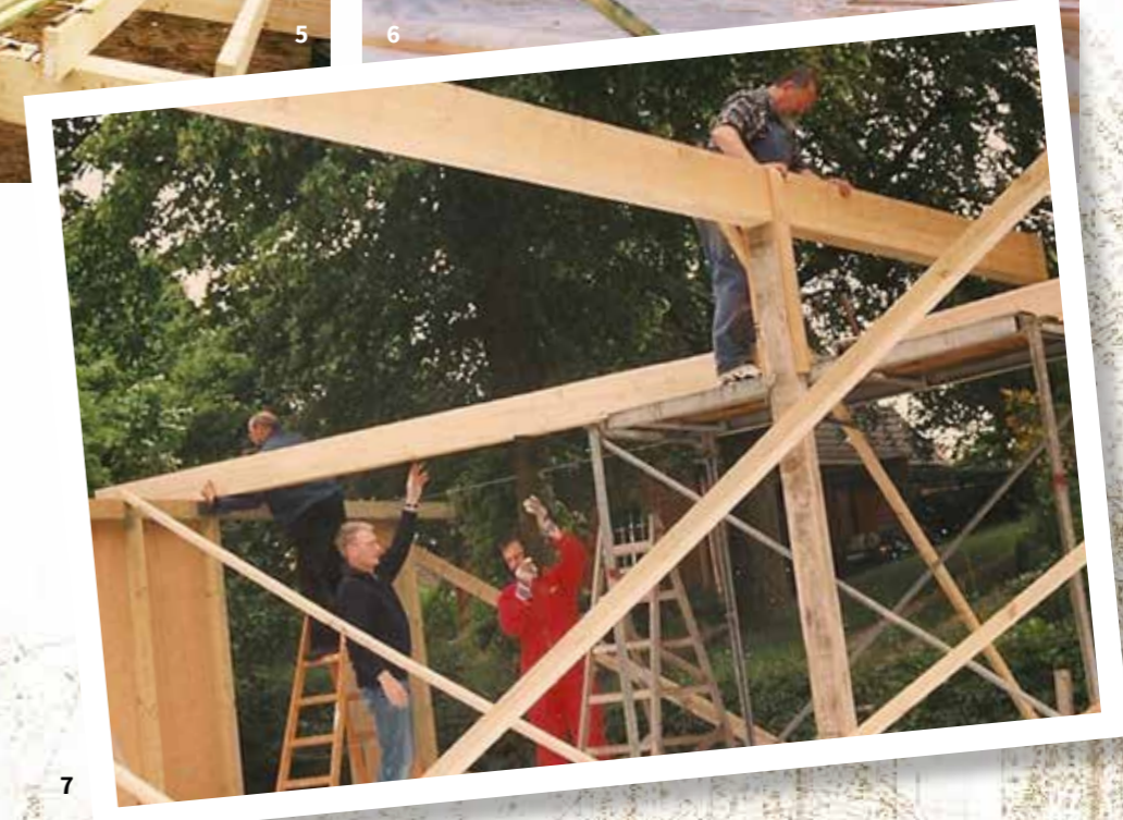
Linke Seite: Das Vereinsgelände im Winter 1987, noch mit dem „Carport“. Diese Seite: 1 Die Kaufbekanntgabe, 1994 2 Bauberatung, April 1995 3 Fundamentgrube, 1995 4 Fundamentringe, 1995 5 Fundamentbalken, 1995 6 Die erste Wand steht, 1995 7 Dachmittelträger, 1995
